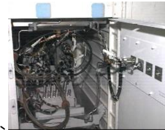
A MAGR installed in Av Bay 3B
